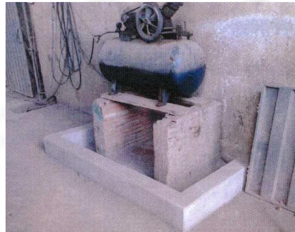
Foto 8: Compressor com bacia de contenção
