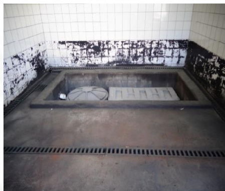
Figura 07: Caixa Separadora de Água e Óleo (Caixa SAO) oficina mecânica
