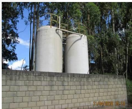
Figura 06: Estação de Tratamento de Efluentes Líquidos Sanitários
