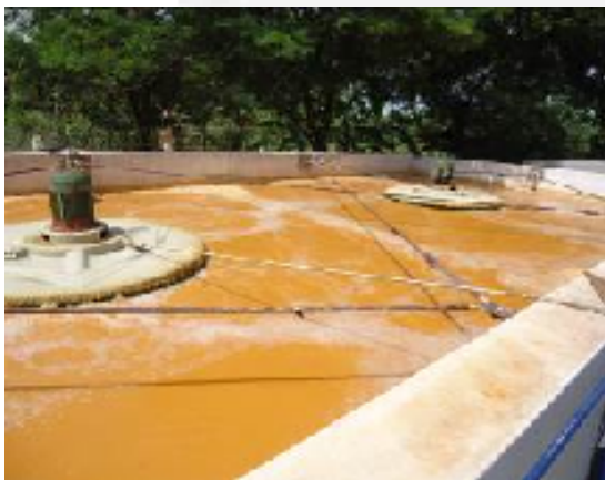
Foto 03. Tanque de aeração da ETEI
