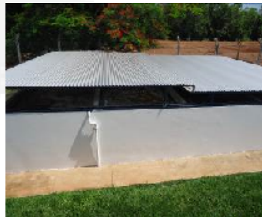
Foto 04. Leito de secagem do lodo da ETEI
