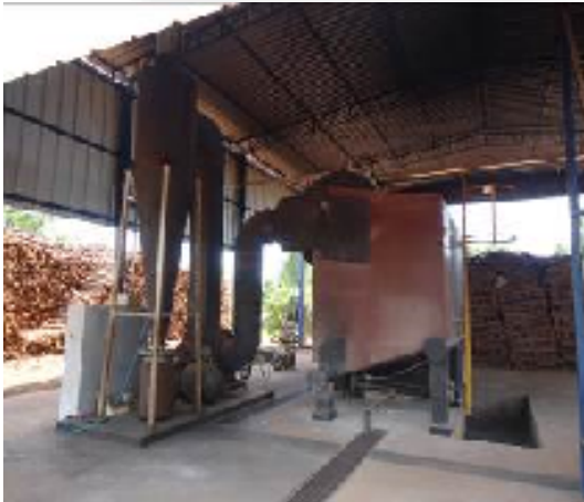
Foto 01. Caldeira para geração de vapor
