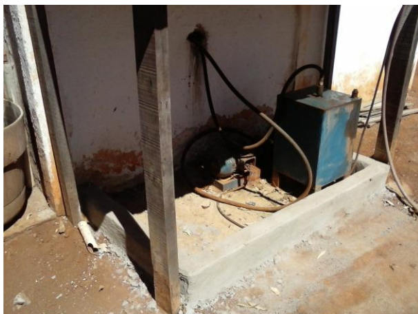
Foto 05. Compressor com contenção
