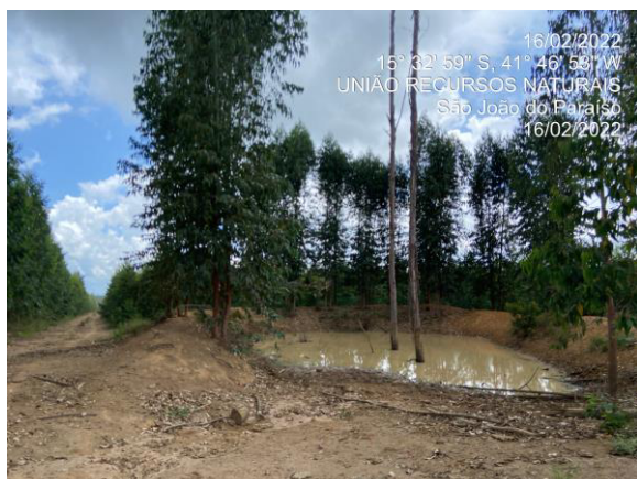
Foto 16 - Bacia de contenção de águas pluviais instalada no empreendimento.
