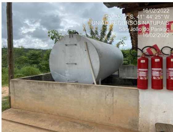
Foto 4 - Tanque de armazenamento de combustíveis do empreendimento.
