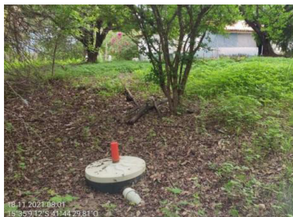
Foto 17 - Sistema de Tratamento de Efluentes domésticos casa 02 do empreendimento.
