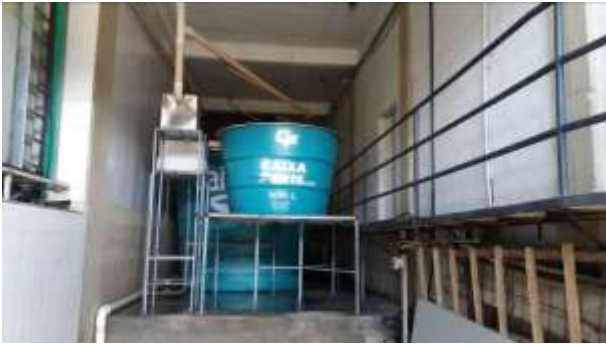
Figura 07: Estação de tratamento de efluentes.
