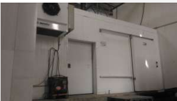
Figura 05: Entrada das câmaras frias.
