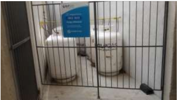
Figura 09: Armazenamento de GLP.
