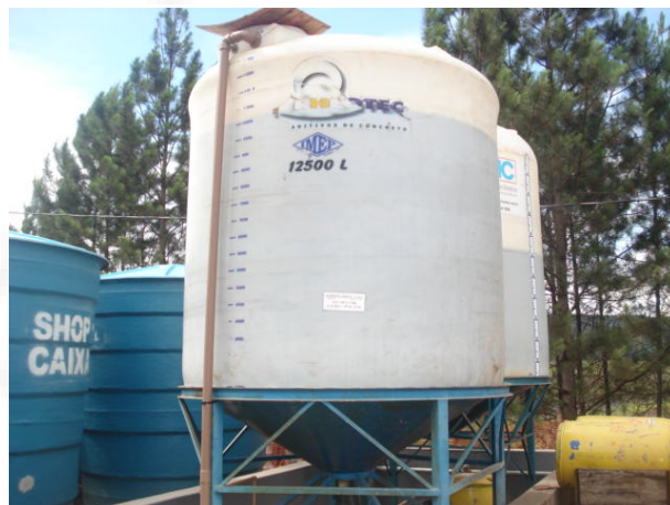
Foto 04. Vista do tanque de aditivos.
