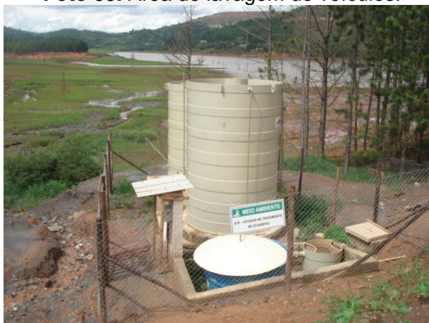
Foto 05. Estação de tratamento de efluentes sanitários.
