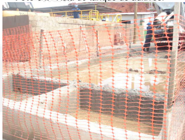
Foto 06. Sistema de sedimentação composto por 1 bate lastro e 2 tanques de decantação.
