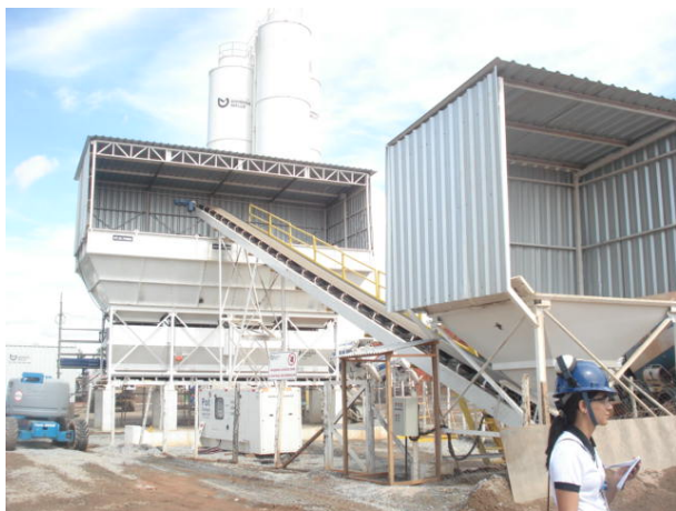
Foto 01. Vista da tremonha de carga e caixa de agregados.
