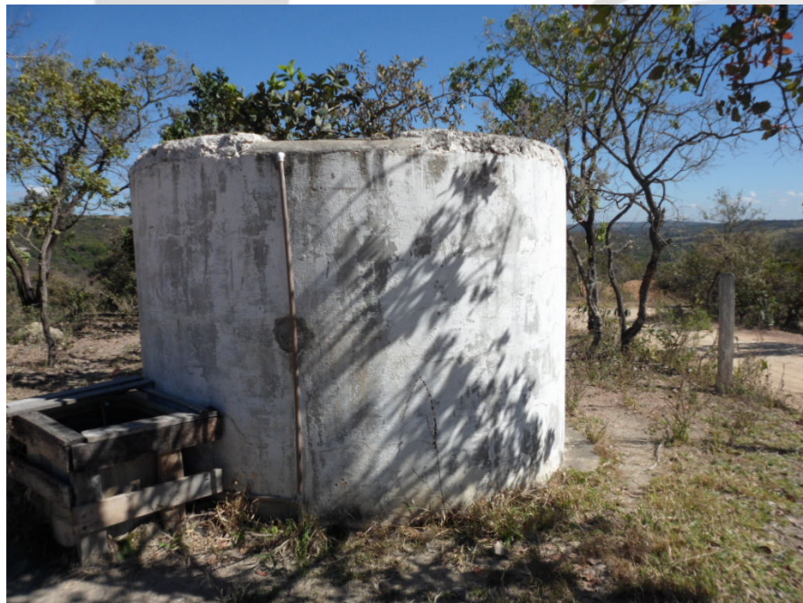
RESERVATÓRIO DE EFLUENTE INDUSTRIAL TRATADO (ÁGUA DE REUSO), DISTRIBUIÇÃO DA ÁGUA DE REUSO POR GRAVIDADE.
