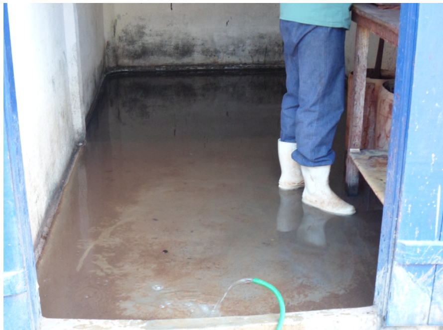
CHEGADA DA ÁGUA DE REUSO NA OFICINA DE TRABALHO.
