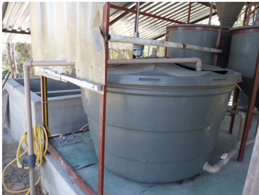
RESERVATÓRIO DE EFLUENTE INDUSTRIAL TRATADO COM BOMBA ELEVATÓRIA SUBMERSA.
