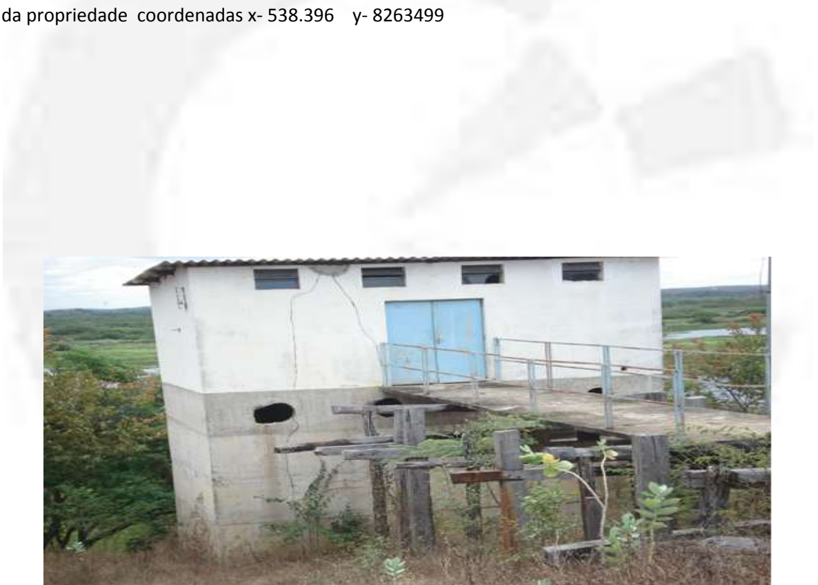
Bomba desativada de Captação de Água, Coordenadas x- 541748 ,y-8264339
