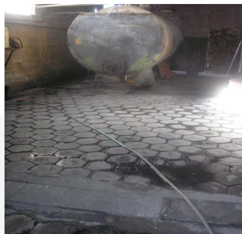
Foto 02. Área da caldeira a lenha.
