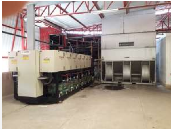
Foto 02: Sala de Gerador de energia
