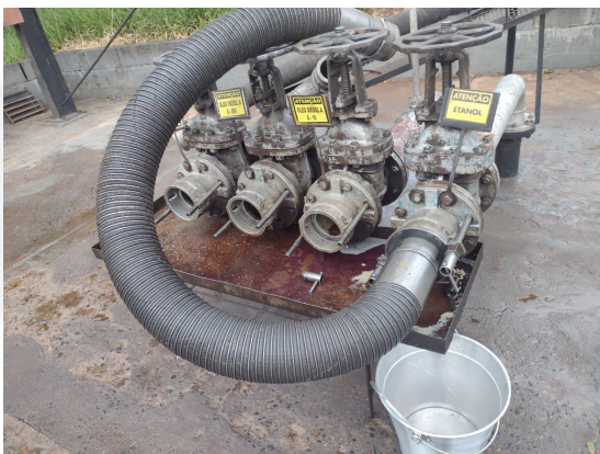
Foto 2: tubulação com conectores
