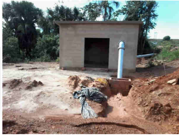
Foto 02. Casa de bomba para captação e irrigação de pivôs.
