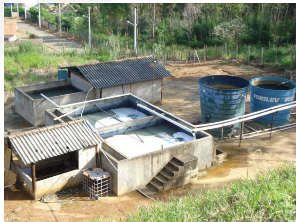
Foto 02. Estação de tratamento de efluentes Industriais
