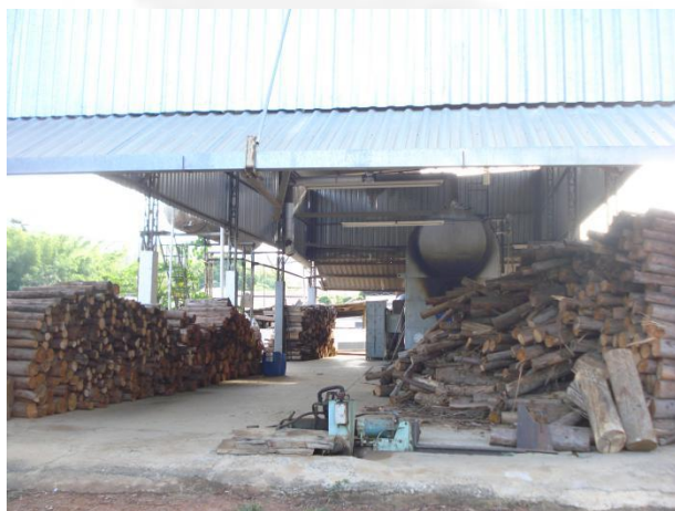
Foto 03. Caldeira e depósito de lenha
