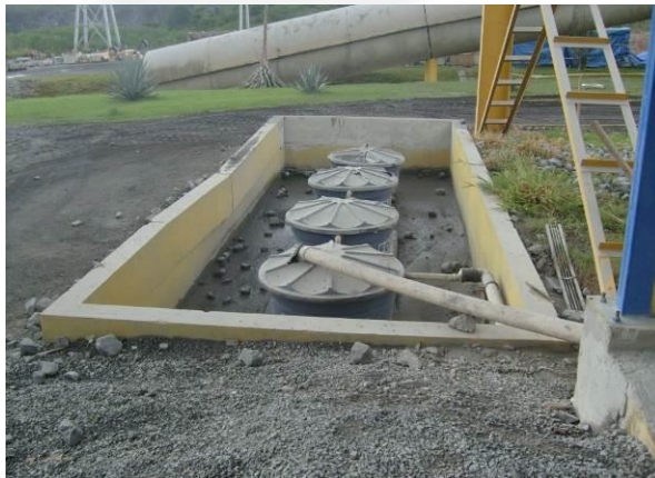
Foto 01. Caixa Separadora de água e óleo da oficina
