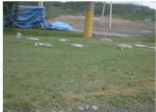
Foto 02. Fossa, filtro e sumidouro.
