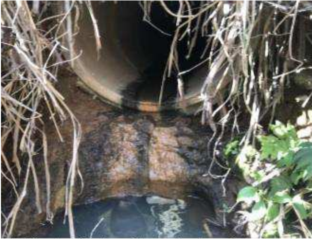
Detalhe da saída da manilha localizada no pé do aterro, sendo possível constatar a diferença na coloração da água proveniente da manilha, compatível com contribuição de águas servidas
