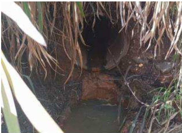
Perfil do terreno na saída da manilha existente, onde vemos uma grande camada de terreno acima da superfície da água
