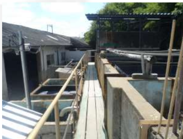
Foto 04: Vista parcial da ETEi
