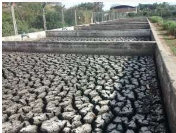
Foto 04. Leitos de secagem da ETE.
