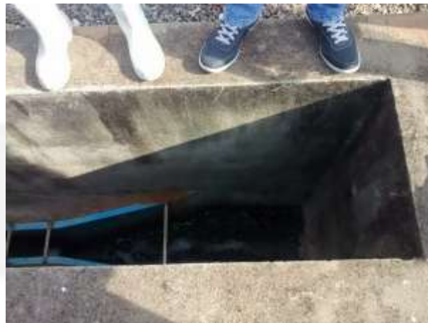
Foto 02. Local de saída do efluente da ETE.
