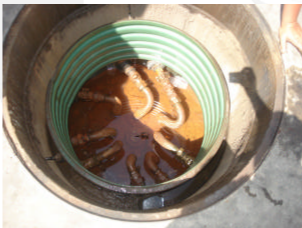
Foto 03. boca de visita com sump e tubulações em PAD.
