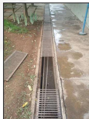
Foto 06: Sistema de drenagem pluvial.
