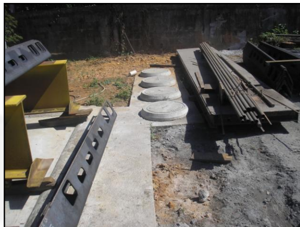
Foto 02: Caixa separadora de Água e Óleo.
