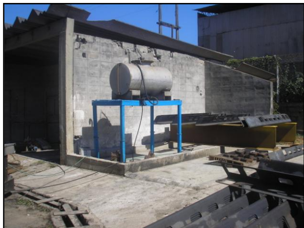
Foto 01: Tanque de abastecimento.
