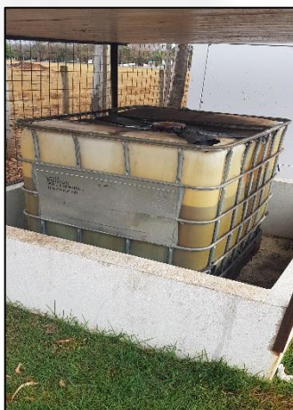
Figura 9: Tanque de diesel do gerador, com bacia de contenção.
