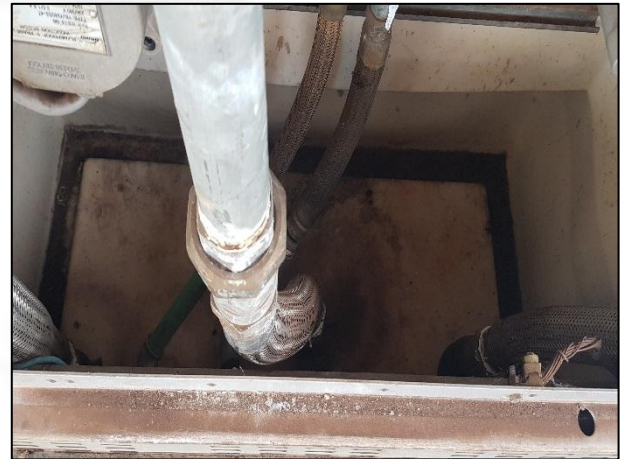
Figura 8: SUMP da bomba de abastecimento com monitoramento instalado.
