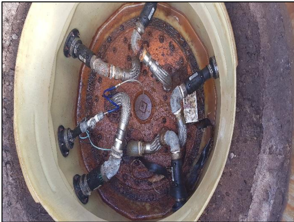
Figura 7: SUMP da boca de visita do tanque com monitoramento instalado.
