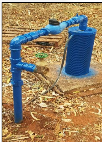
Figura 3: Poço tubular com hidrômetro.
