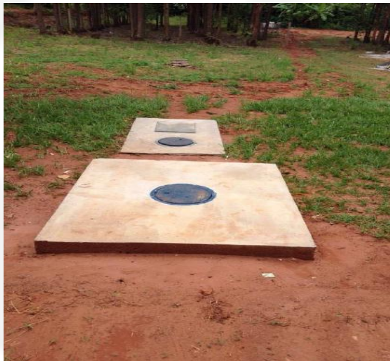
Figura 01 – Fossa séptica do empreendimento.
