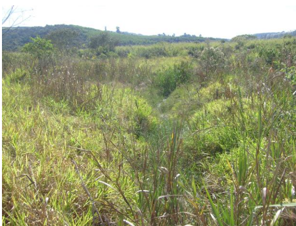
Foto 7: Sistema de drenagem.
