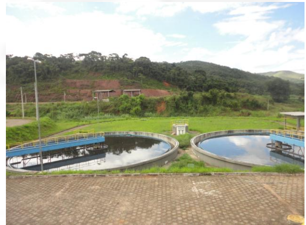
Foto 04. Vista parcial dos decantadores secundários já existentes.
