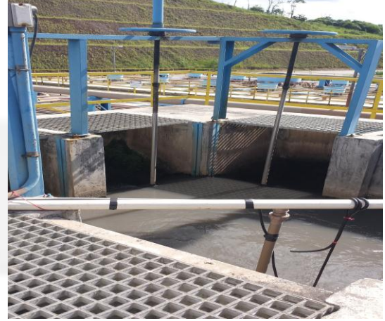
Foto 02. Vista parcial dos reatores UASB já existentes.
