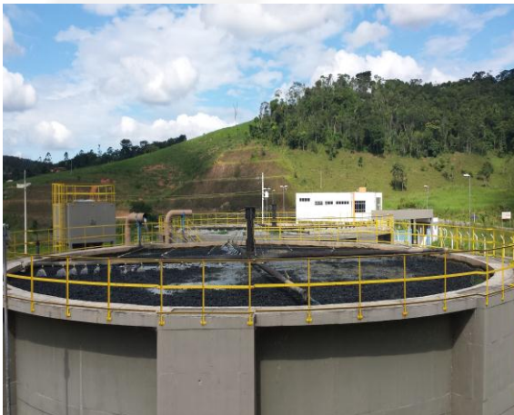
Foto 03. Vista parcial dos filtros biológicos já existentes.
