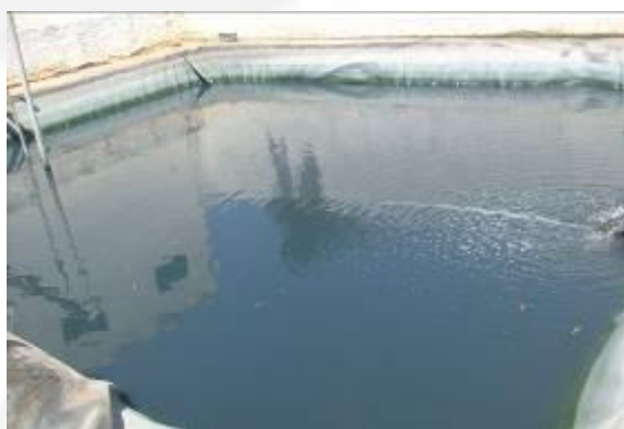
Foto 16: Tanque de lodo.
