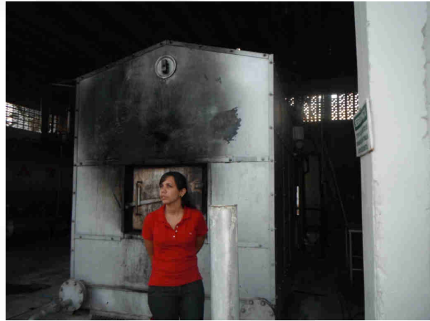
Foto 02. Caldeira a Material Lenhoso
