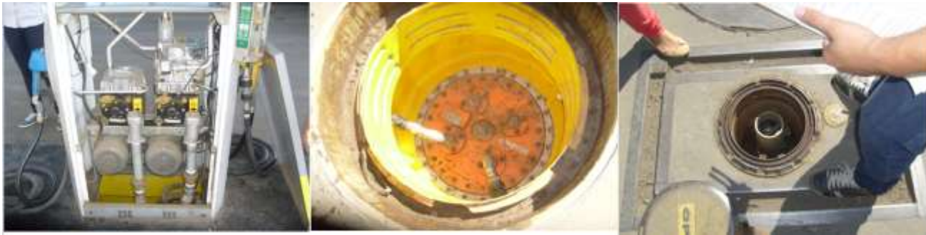
Dispositivos de segurança contra vazamento e transbordamento. Fonte: SUPRAM NM (2014)
