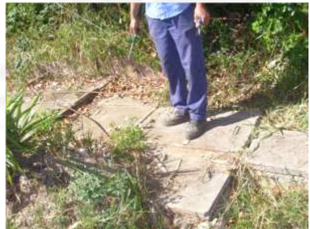
Sistema tanque séptico e filtro anaeróbio.
