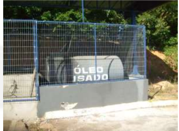
Armazenamento de óleo usado.
