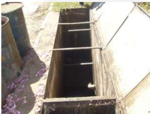
Caixa Separadora Água e Óleo- CSAO.
