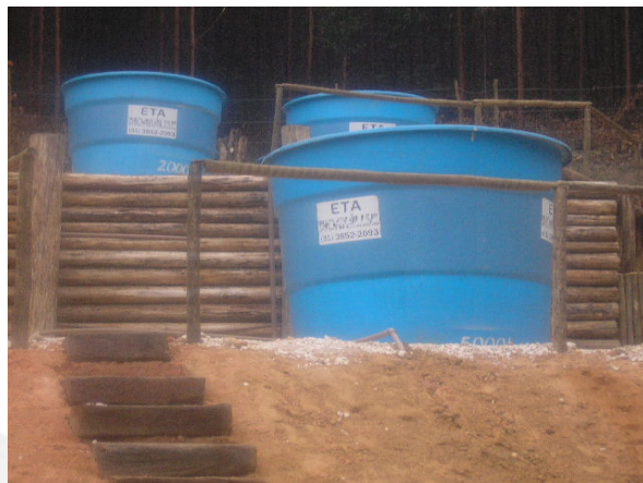
Foto 06 – Estação de Tratamento de Água.
