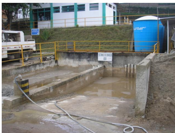
Foto 03. Bate lastro: recuperação de água para o processo e destinação do resíduo sólido ao aterro municipal.
