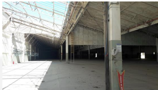
Galpão a ser restaurado
