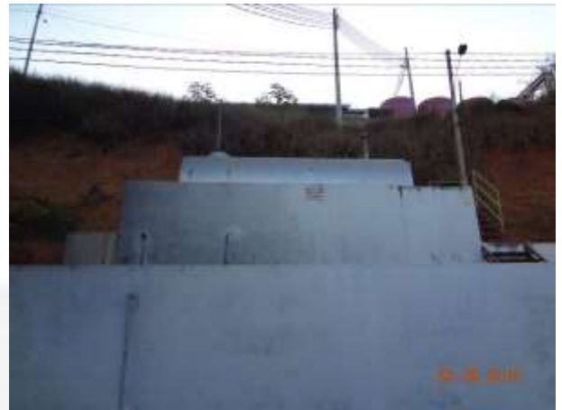
Fig. 10 – Tanque de diesel utilizado única e exclusivamente para os geradores.
