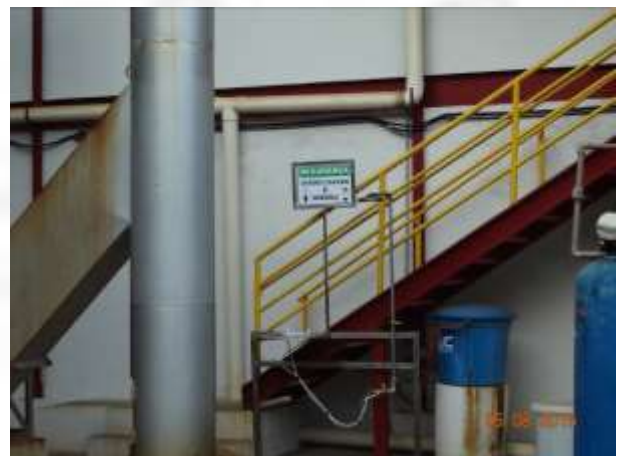
Fig. 12 – Chuveirão com lavador de olhos
