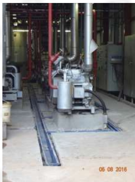
Fig. 8 – Compressores do sistema de geração de frio do empreendimento.
