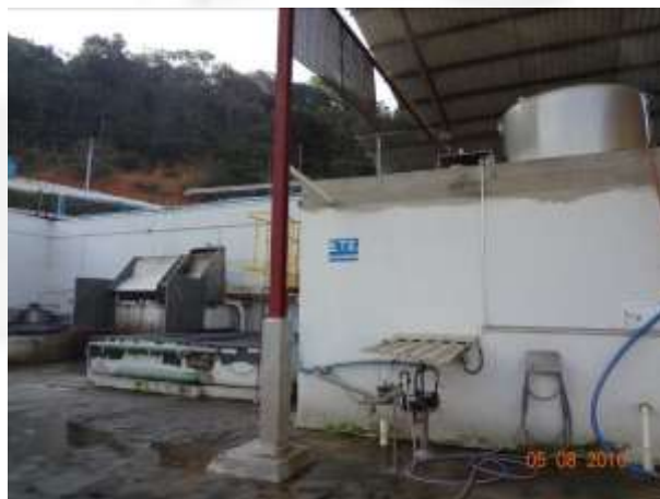
Fig. 4 – Vista geral do sistema de tratamento dentro do abatedouro.
