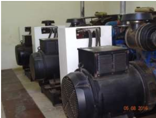
Fig. 9 – geradores movidos a Diesel
