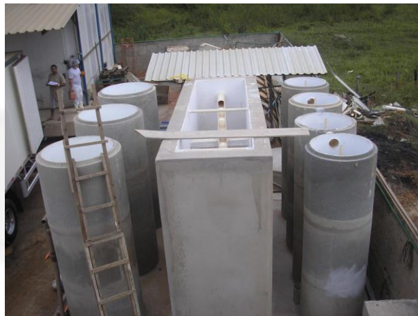
Foto 02. Estação de Tratamento de Efluentes (ETE)
