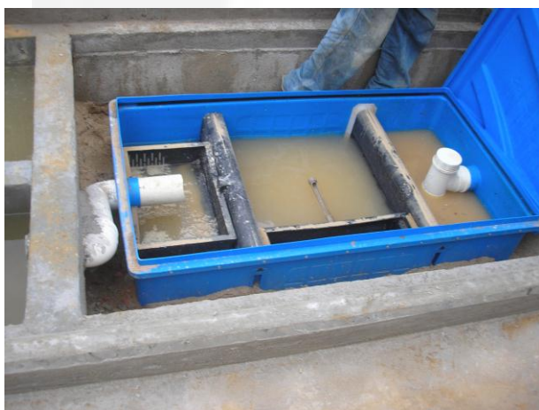
Foto 03. Caixa Separadora de Água e Óleo (SAO)
