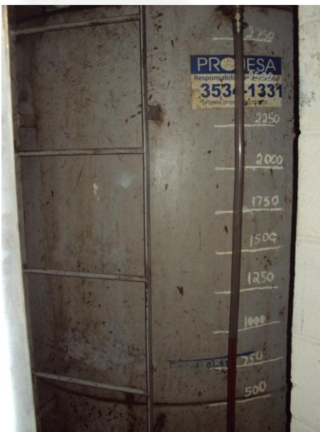
Foto 11. Tanque de abastecimento
