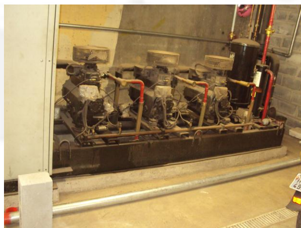
Foto 12. Canaletas dos compressores
