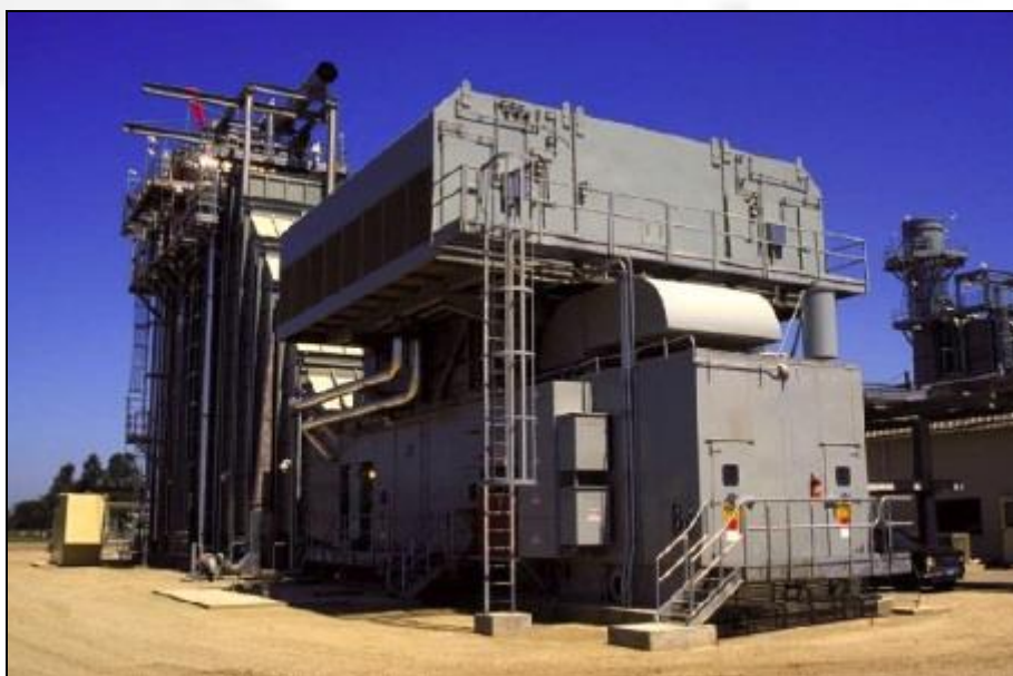
Figura 03: Central termoelétrica com Turbinas LM 6000. Fonte: RCA
