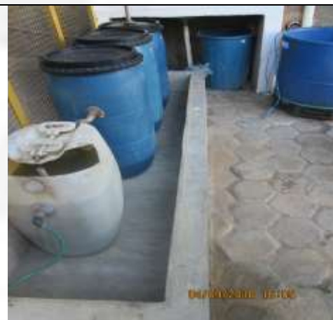
Foto 8. Caixa SAO para tratamento da purga dos compressores (seta vermelha).
