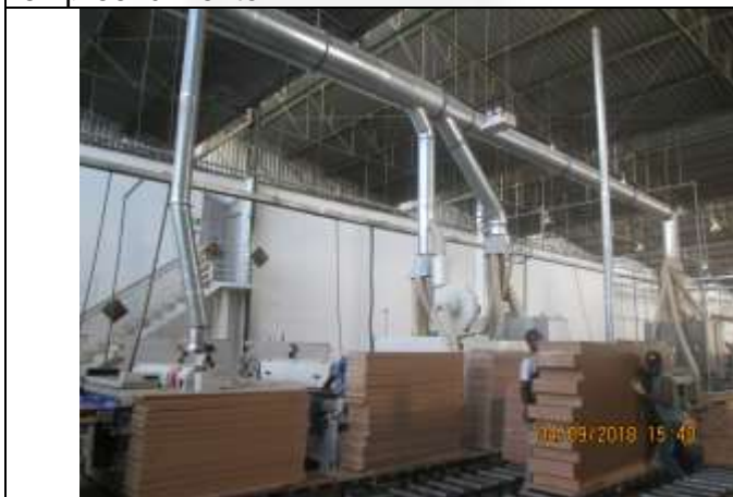
Foto 3. Setor de produção. Mostrando máquinas estão conectadas ao sistema de exaustão.
