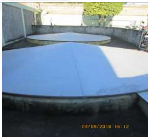
Foto 9. Sistema fossa filtro do empreendimento.
