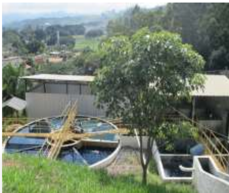
Figura 04: Estação de tratamento de efluentes industriais (ETEI)
