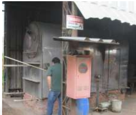
Figura 05: Caldeira de 1000Kg/h de vapor
