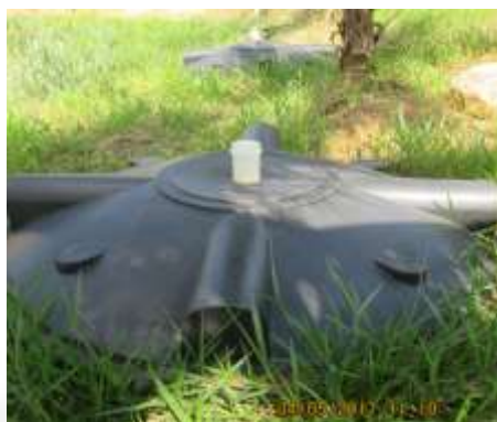
Figura 03: Sistema de tratamento de efluentes sanitários
