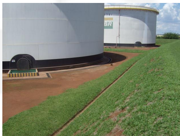
Tanques atmosféricos e bacia de contenção de terra compactada – Transpetro Uberaba
