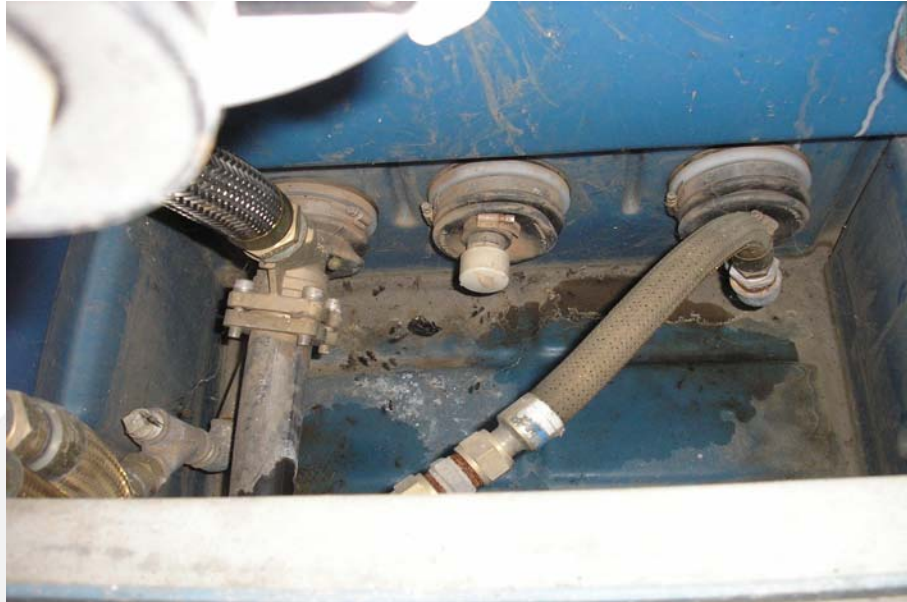
Foto 1- Sump de bomba de abastecimento.
