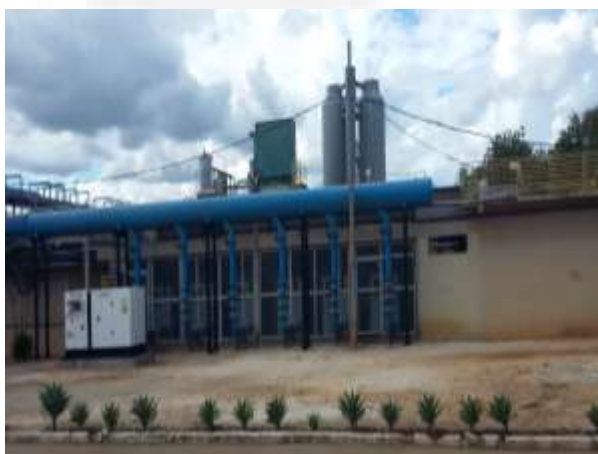
Foto 03. Sala de sopradores
