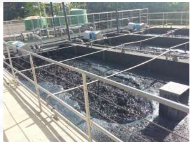
Foto 02. Tanques com módulos de membranas
