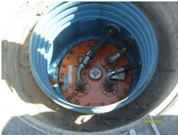
Figura 06: SUMP da boca de visita do tanque de combustível. Fonte: SUPRAM-NM, 2014.
