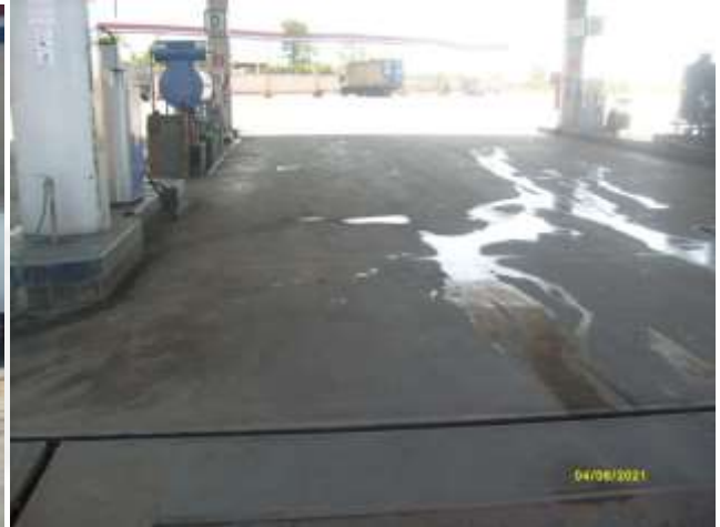
Figura 04: Piso da Pista de Abastecimento. Fonte: SUPRAM-NM, 2014.
