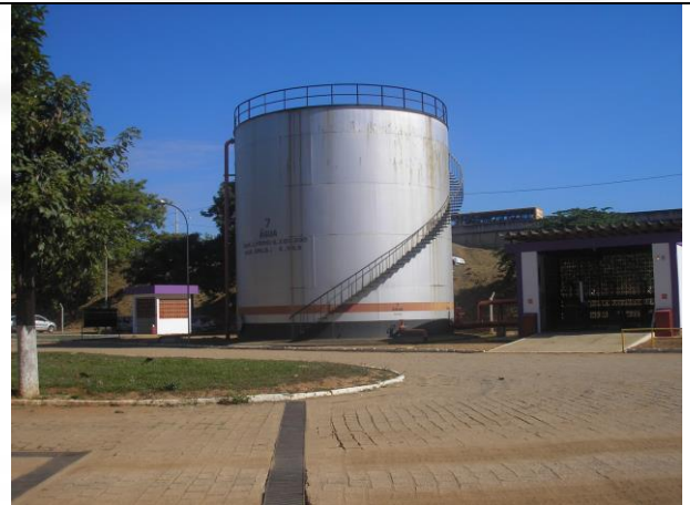
Foto 04. Tanque de água para atender ao sistema de combate a incêndios. Data: 16/04/2015.
