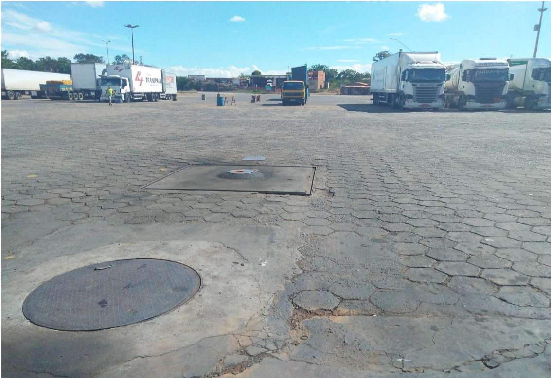
Imagem 1 – Vazamento no entorno da boca de descarga de combustível.
