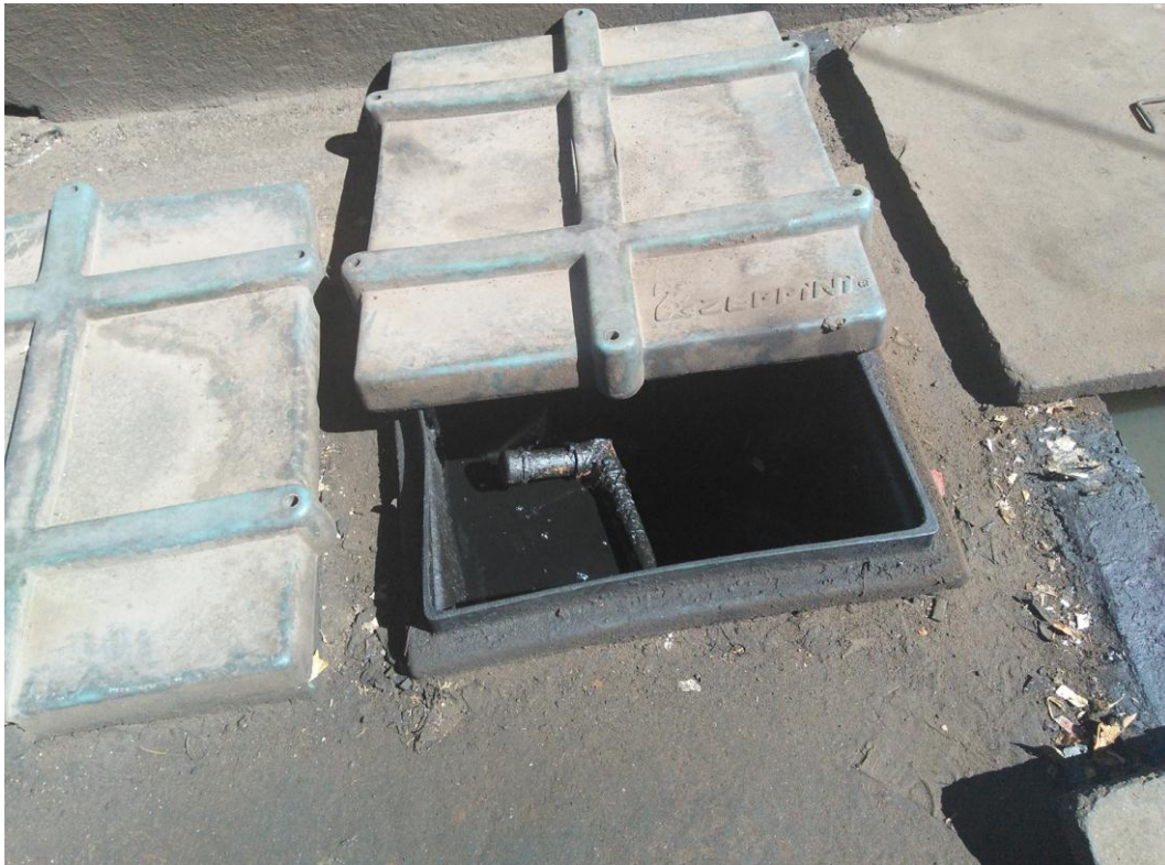
Imagem 3 – Falta de manutenção da caixa SAO
