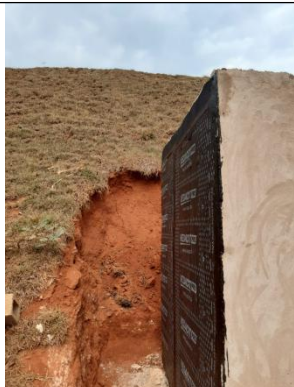
Foto 12 b. Abrigo de máquinas construído na base do piscinão do efluente das lagoas de tratamento de dejetos animais (reservatório "off stream")
