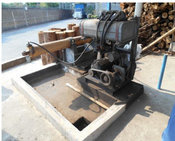
Foto 5: Bacia de contenção de vazamentos.
