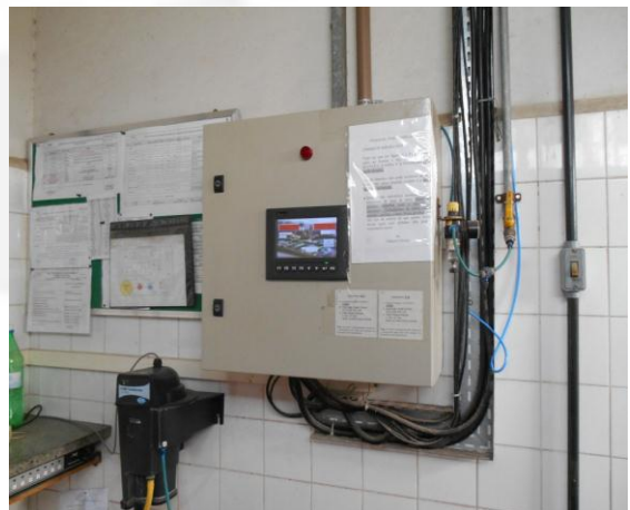
Foto 16: Controle automatizado da ETE.
