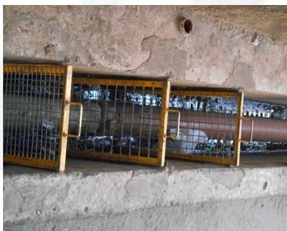
Foto 10: Estrutura de drenagem pluvial.
