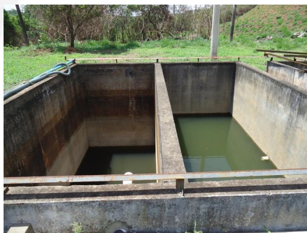
Foto 08. Estação de tratamento do percolado do aterro.
