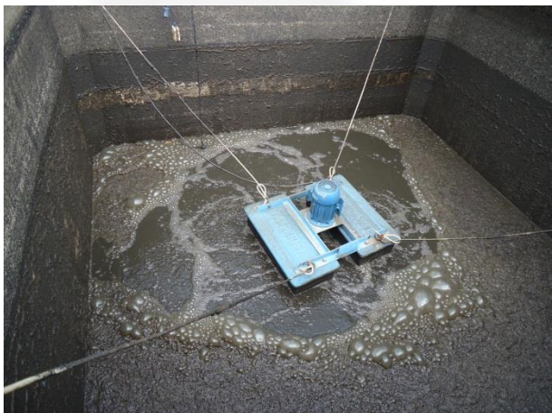
Foto 03. Sistema de tratamento de efluentes sanitários: planta industrial
