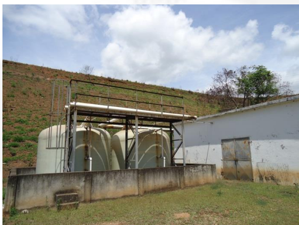
Foto 07. Estação de tratamento do percolado do aterro.
