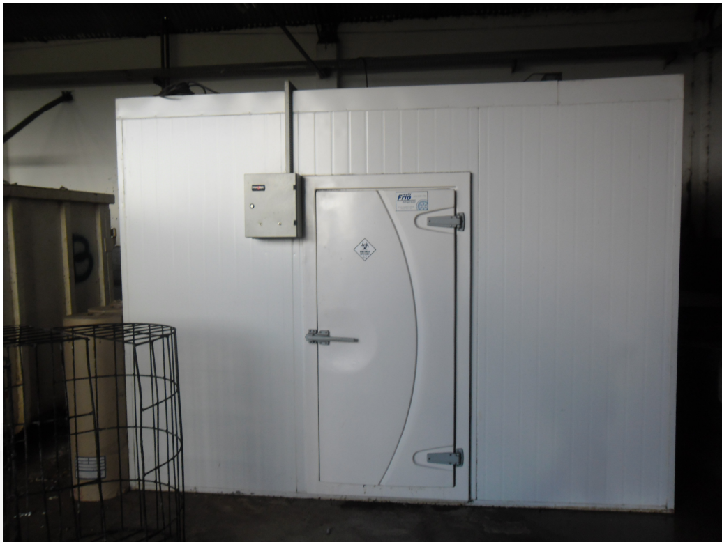
Foto 02: Câmara fria onde são acondicionados os resíduos grupo A2 e A3. Fonte: SUPRAM TMAP, 2013
