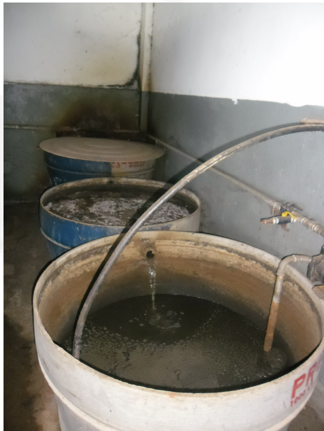
Foto 03: Tanques onde efluente líquido é previamente tratado Fonte: SUPRAM TMAP, 2013
