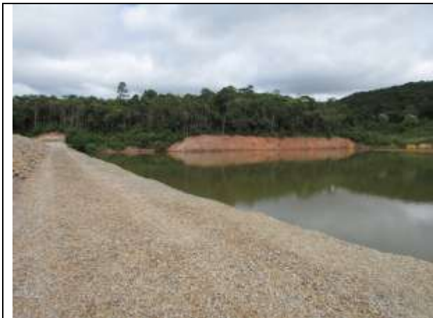
Foto 01. Dique de Contenção de Sedimentos. (Data do registro: 18/04/2017).
