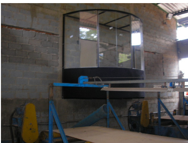
Foto 15: Parte interna da UTM.
