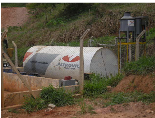
Foto 17: Setor de armazenamento de combustível.
