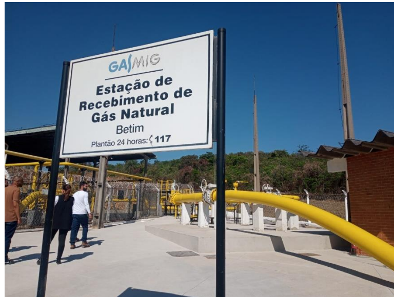
Figura 8: Estação de Recebimento de Gás Natural ERGN / City Gate Bairro Petrovale, Betim/MG, local em que o gás é entregue pela Petrobrás, próximo à REGAP. (Coordenadas 19°58'50"S, 44°06'14"O) (Fonte: FEAM/DGR, setembro/2023).
