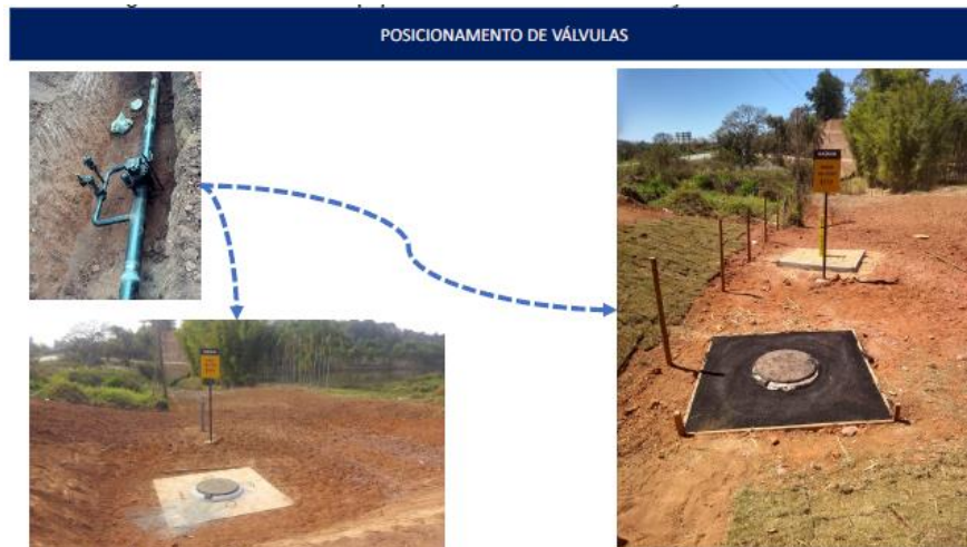
Figura 11: Detalhe do equipamento de válvula instalada no eixo do gasoduto. (Fonte: EIA – Gasmig, 2021).
