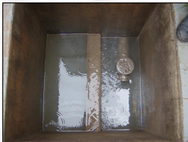
Foto 04: Efluente na saída da Caixa SAO
