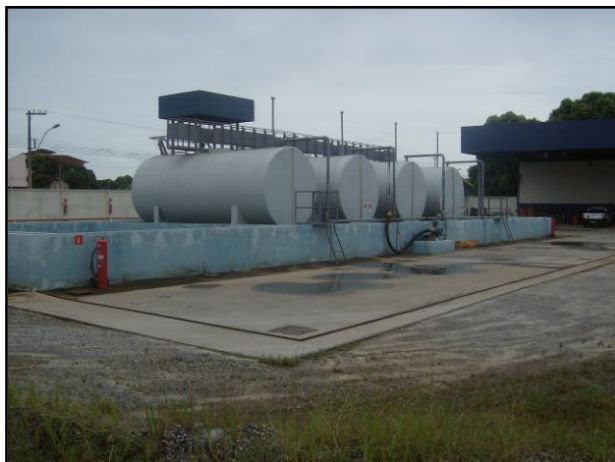
Foto 01: Tanques de armazenamento de combustível
